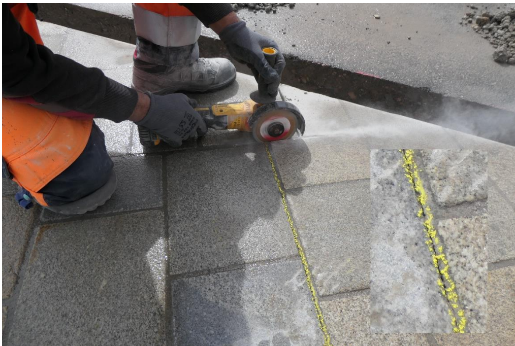
Bild 5: Aufweiten von Rissen bei einer Pflasterdecke in gebundener Ausführung (Foto: B. Burgetsmeier)
