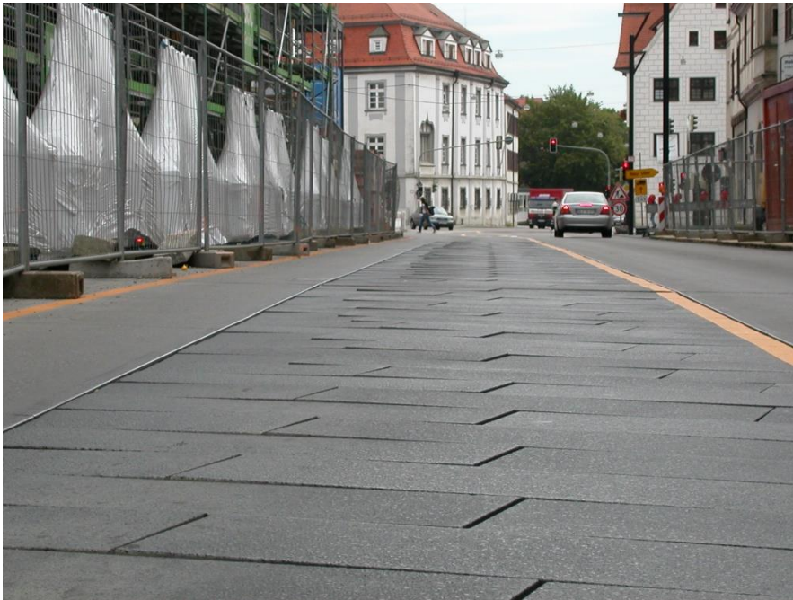
Bild 3: Beispiel für Unebenheiten (Stufenbildung) an einem Belag aus Großformaten in ungebundener Ausführung (Foto: A. Eichler)
